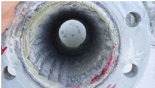
Fig. 1 サンプル直後の配管スケール
