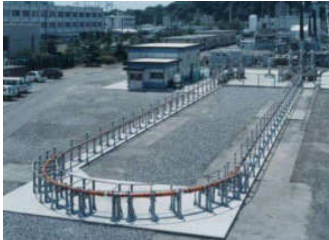
送電ケーブル
