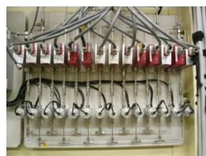
ガス混合装置
