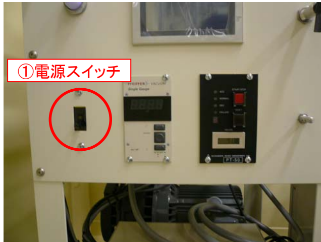
図 真空ポンプ(実験ハッチ内)
