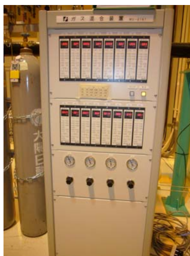
図 ガス混合装置
