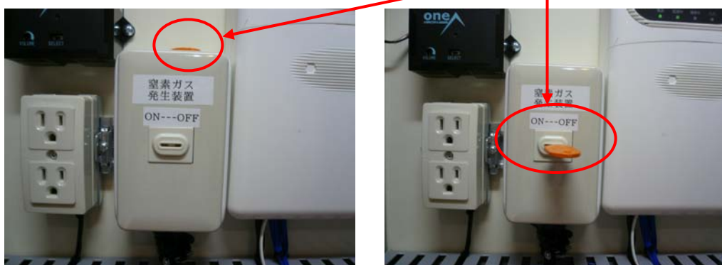
図 窒素ガス供給装置電源スイッチ
